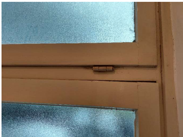
Battente chiuso non combacia con telaio
